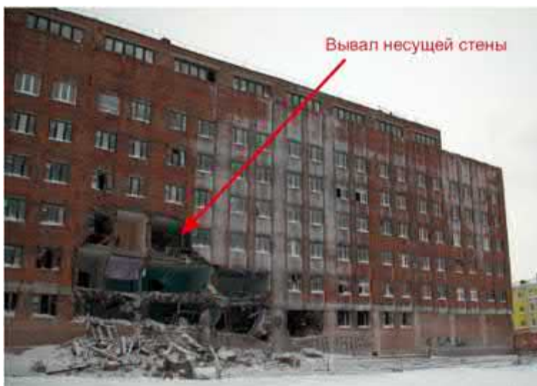
Рисунок 6 Разрушения административных зданий г. Норильска
