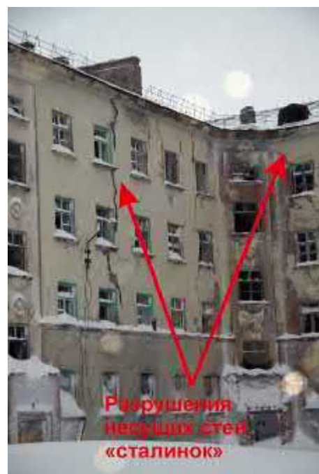
Рисунок 7. Разрушения жилых зданий г. Норильска
